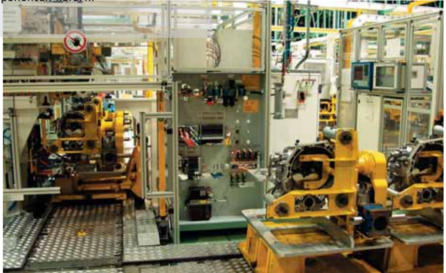
Palettenwagen in der Getriebemontage. Im Ventilstand sind Ventilträgersystem HF03 mit zentralen und dezentralen Bus-Modulen.
