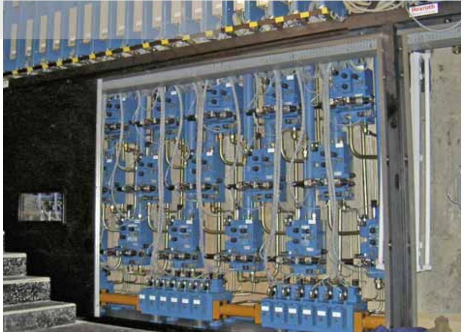
Im Landestheater Linz beeindruckt die Energiedichte der Maschinengalerie sowohl hydraulisch als auch elektronisch.
